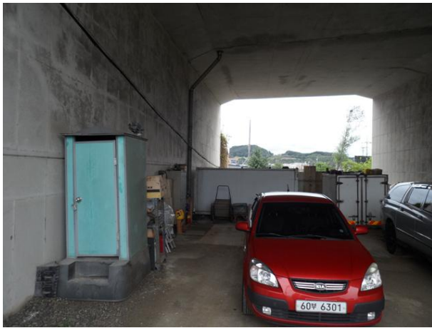
교량 하부 무단점용 및 적치(S1)
